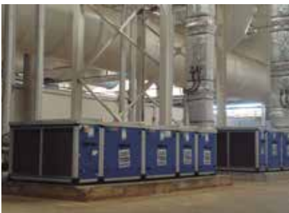
Data Center do Santander possui controle de umidade pelo ar externo de renovação
