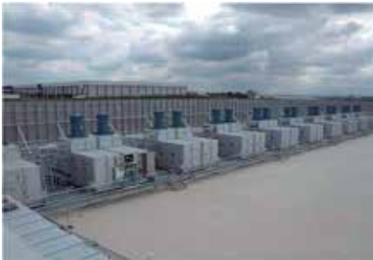
Free cooling aproveita as condições externas para retirada do calor dos racks
